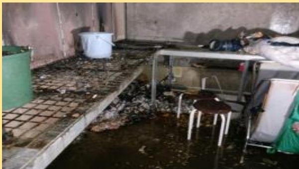
実際の火災現場
