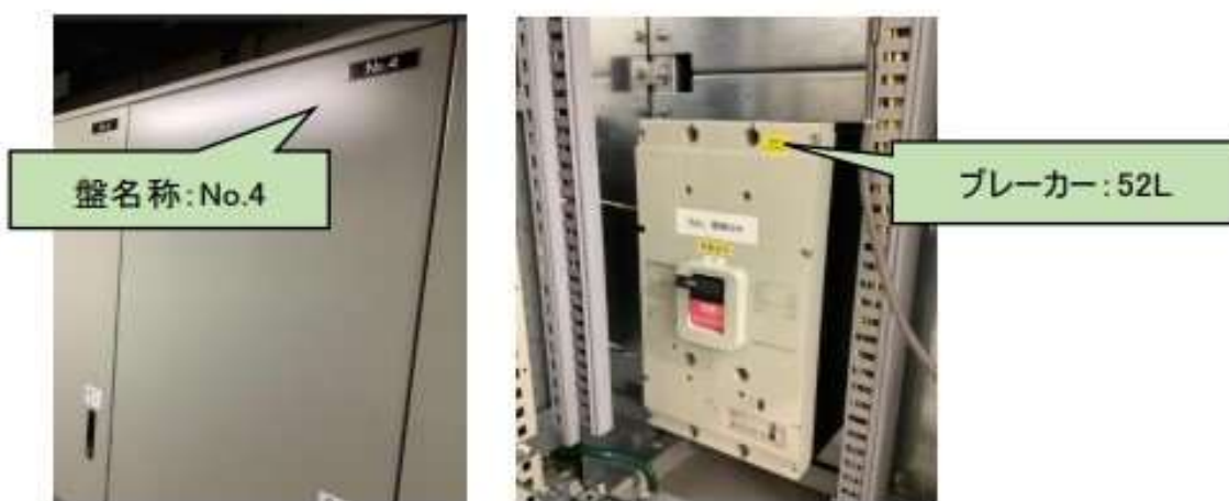
誤って「切」にした盤N04 (CV4) 内のブレーカー (52L)
