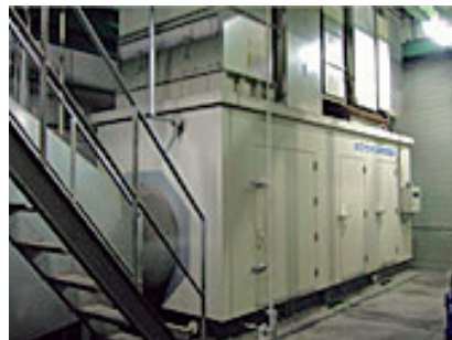
コージェネレーション発電設備
